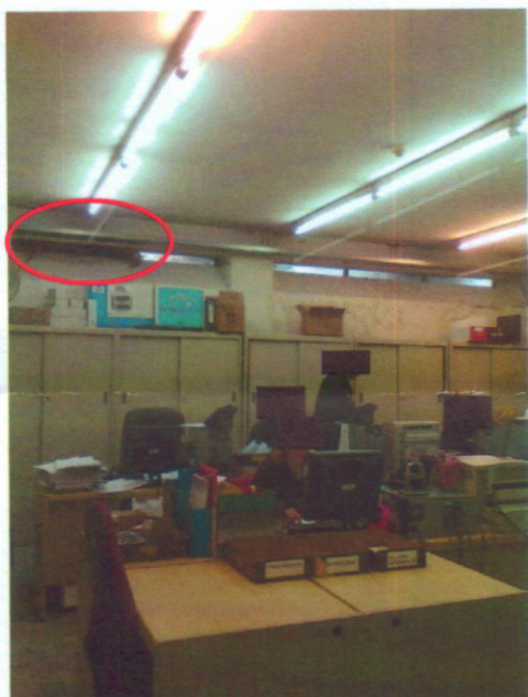
Ilustração 14: Pequena abertura tapada devido à entrada de gases automóveis, e frio de Inverno.
