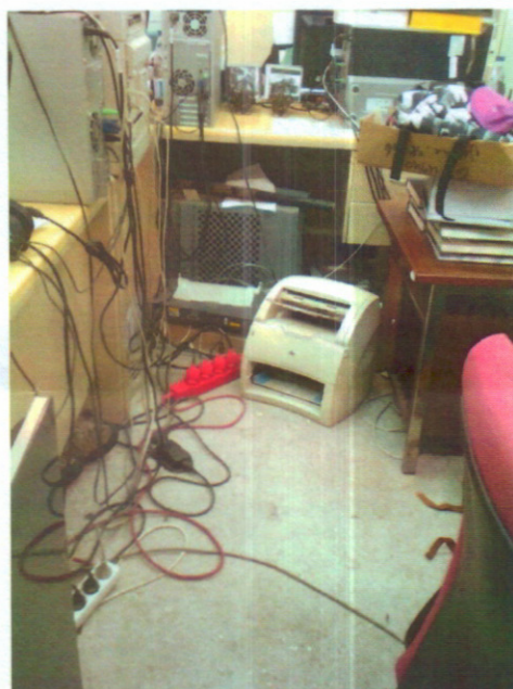
Ilustração 15: Sobrecarga eléctrica e falta de revestimento do pavimento.
