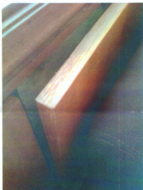
Ilustração 10: Revestimento das paredes degradados.
