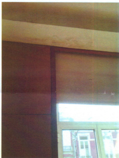
Ilustração 3: Evidências de humidade.
